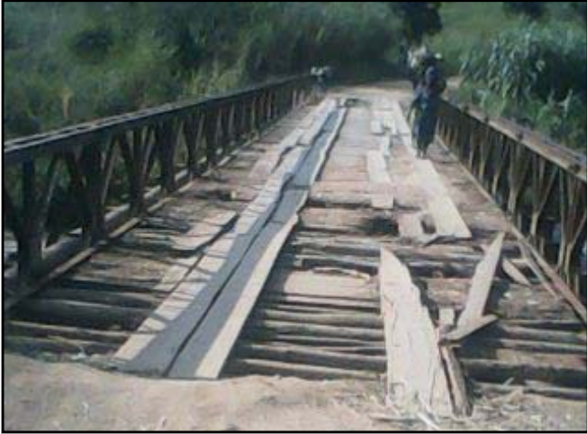
Kolomani en Ituri avant l'intervention
