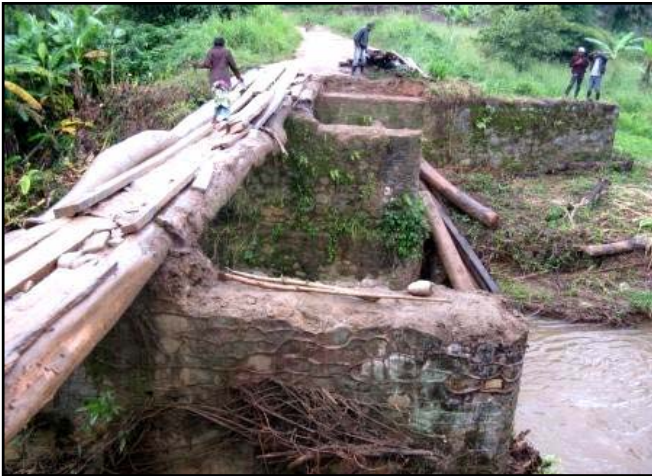
Pont de Mabalako avant l'intervention
