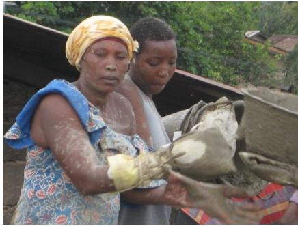
Mme Yvone Nduwimana, une des déplacés vivant dans une caserne militaire et employée dans la réhabilitation des casernes, Bujumbura
