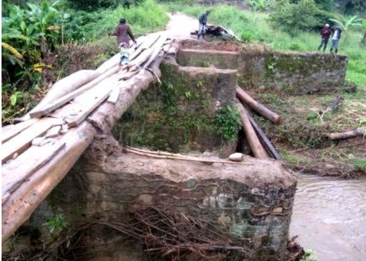
Pont de Mabalako avant l'intervention
