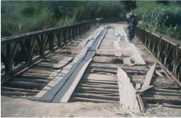
Pont de Kolomani en Ituri avant l'intervention
