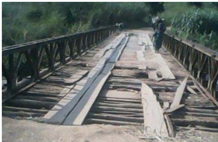
Pont de Kolomani en Ituri avant l'intervention
