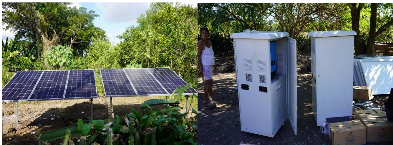
Fotos: Imágenes de los módulos fotovoltaicos instalados en la comunidad y gabinetes tecnológicos usados en la implementación de los sistemas.
