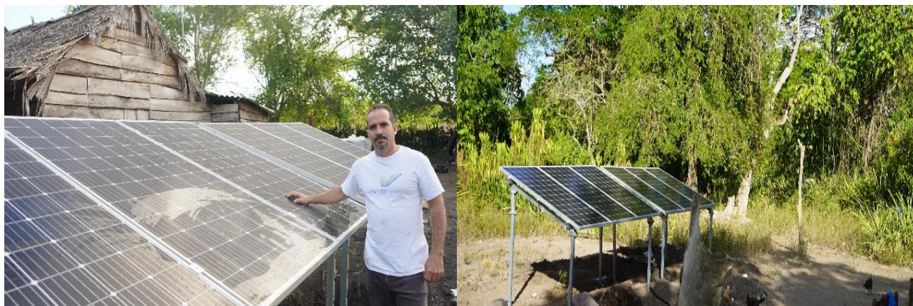
Fotos. Humedad que puede afectar los equipos y efectos de sombras en algunos casos ya instalados. Fuente: Equipo nacional de Proyecto FRE local 2022.
