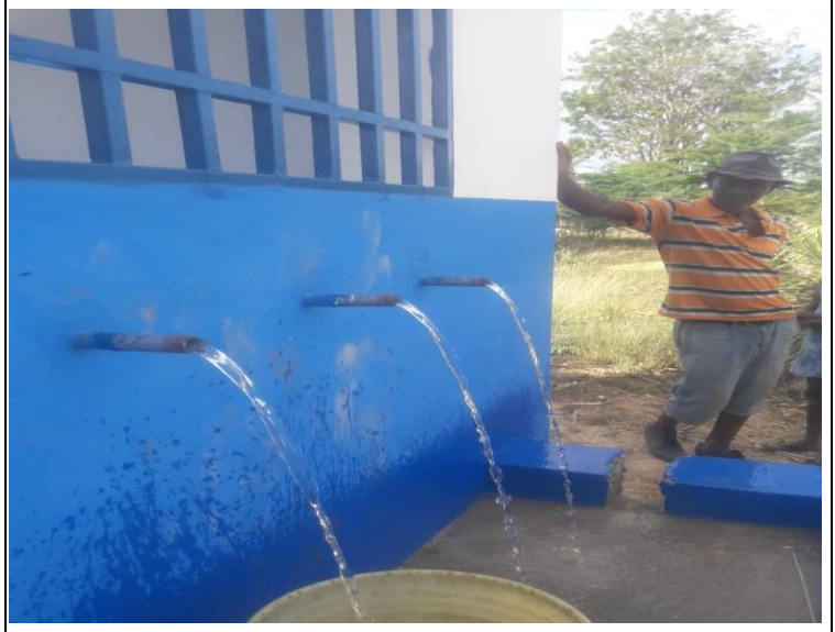
Grand Boucan – Borne fontaine, Système d’adduction d’eau potable
