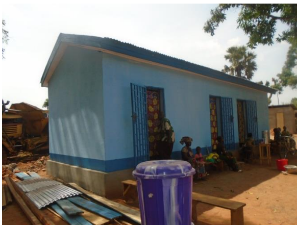
Photo : Salle d'accouchement du CS de Mbangolo réfectionnée avec extension de la pièce
