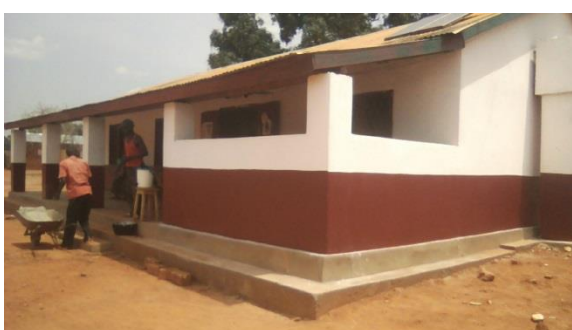
Photo : CS de Seko, bâtiment principal réfectionné (salle de réception et des soins)
