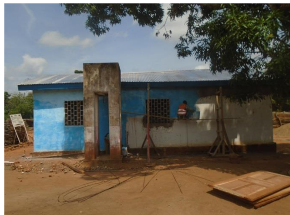
Photo : Réfection du bâtiment principale du Centre de santé de Mbangolo (Salle de consultation, pharmacie et petite chirurgie)
