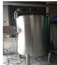
Tanque fundidor y almacenamiento
