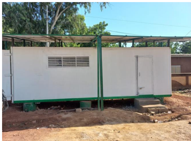
Photo 6 Chambre froide solaire à Ségou_Octobre 2024_Crédit Photo DRP Ségou
