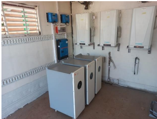
Photo 6 Intérieur de la chambre froide solaire avec les nono-bloques et les batteries lithium 6KVA_Crédit Photo DRP Ségou
