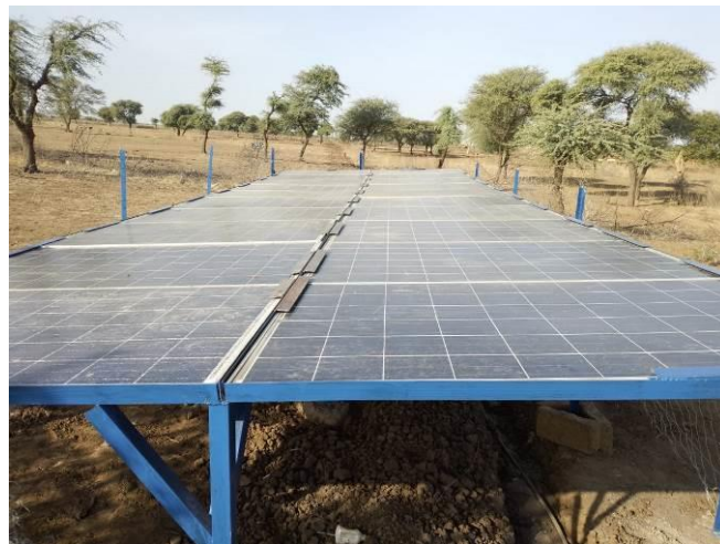
Photo des panneaux solaires du 2 ème forage de Birou petit.
