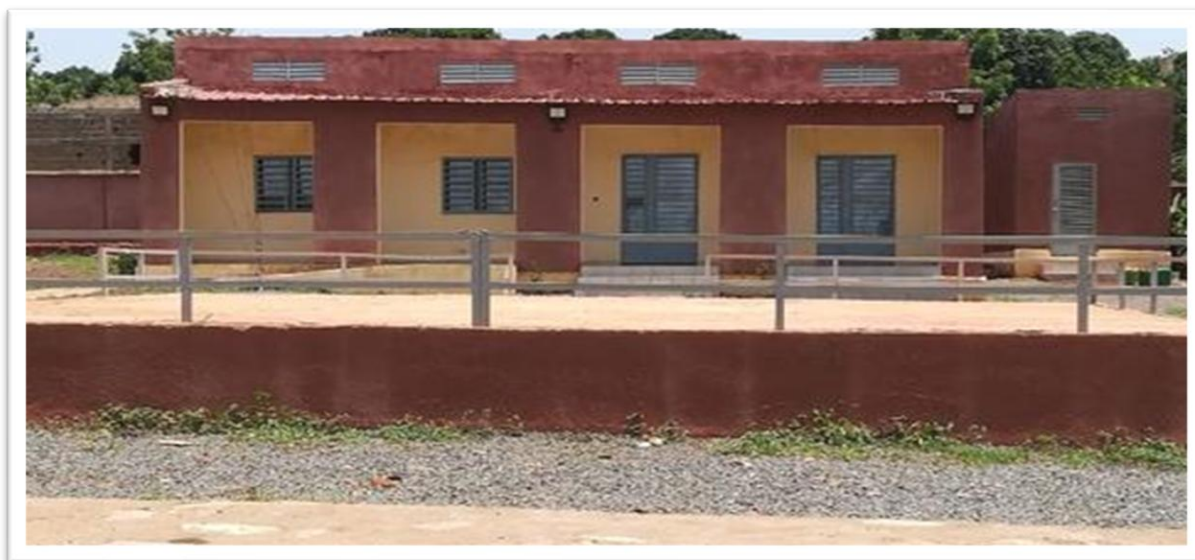
@ AMD International. Centre de jeunes de la commune IV de Bamako réhabilité par le projet « An be gnokon bolo »
