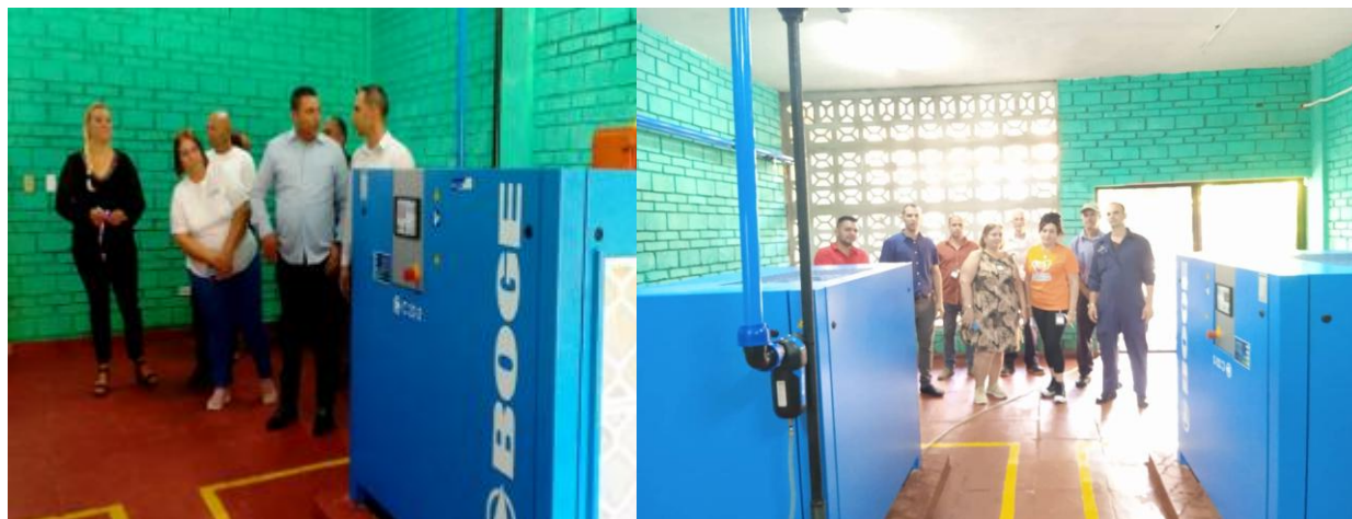
Fotos: Área de compresores del proyecto demostrativo de Oleohidráulica Fuente: ONURE-ONUDI.2024
