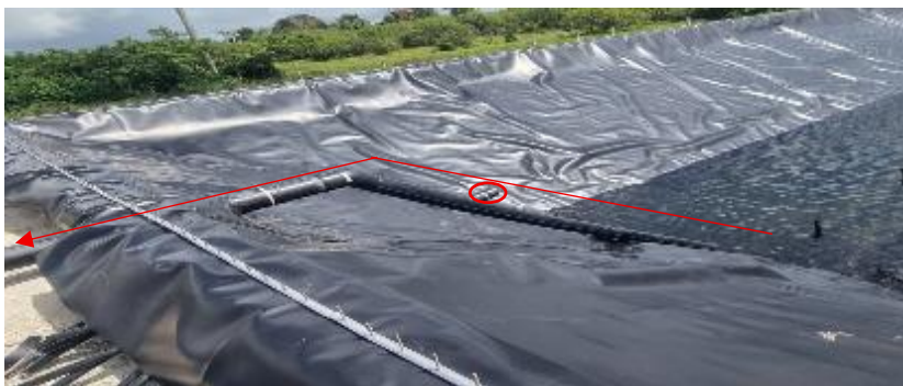
Foto: Línea de conducción de lodos desde el biodigestor hasta la cámara de bombeo (identificada con una línea)
