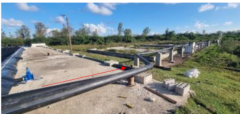
Foto: Línea de conducción de lodos hacia los platos de secado
